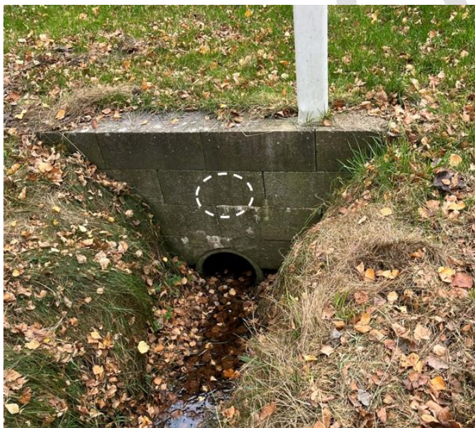
Figur 5.2: Eksempel på eksisterende overkørsel langs Grøftekanten. Foreslået placering til ekstra rørgennemføring markeret med stiptet hvid, for øget kapacitet ved spidsbelastning.
